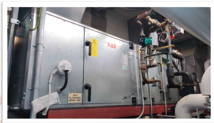
Kuva 2. Tuloilmakone TK 202 A-osan lämmönjakohuoneessa.
