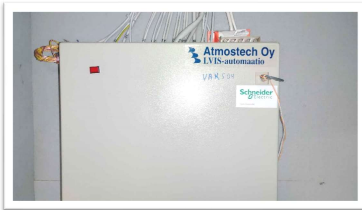
Kuva 4. Valvonta-alakeskus D-osan IV-konehuoneessa.
