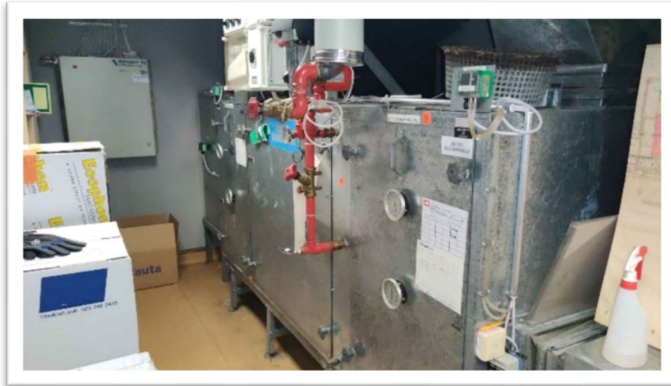
Kuva 1. LTO-ilmanvaihtokone 206 D-osan IV-konehuoneessa
