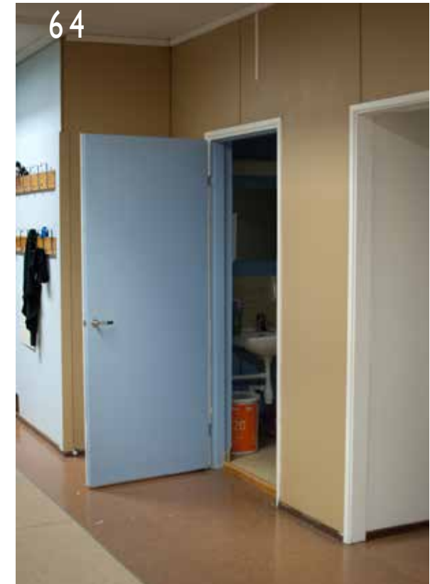
62-64 Laajennusosan eri-ikäisiä ovia. Vasemmalla juhlasalin lasi-puu-rakenteiset peiliovet. Keskellä keittiön ovi 2000-luvun alun kahvilamuutoksesta. Oikealla yläaulan wc-tilaan johtaa tyypillinen peruskorjauksen aikainen laaka-ovi.
