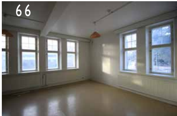
65 Ylimpään kerrokseen vuonna 1910 järjestetyn luokkahuoneen ikkunoissa on kahta eri ikkunatyyppiä kahdesta eri laajennusvaiheesta. Sekä yksi- että kaksijakoisissa ikkunoissa on kaikissa sama määrä ruutuja.
